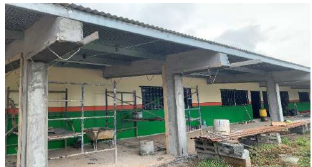
Construcción de aulas de primaria / agroecología y Área de costura en el IPHE de Chorrera.
